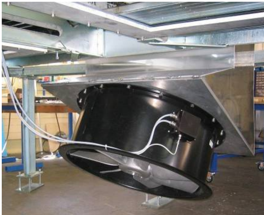
Fig.: Cooling fan system
